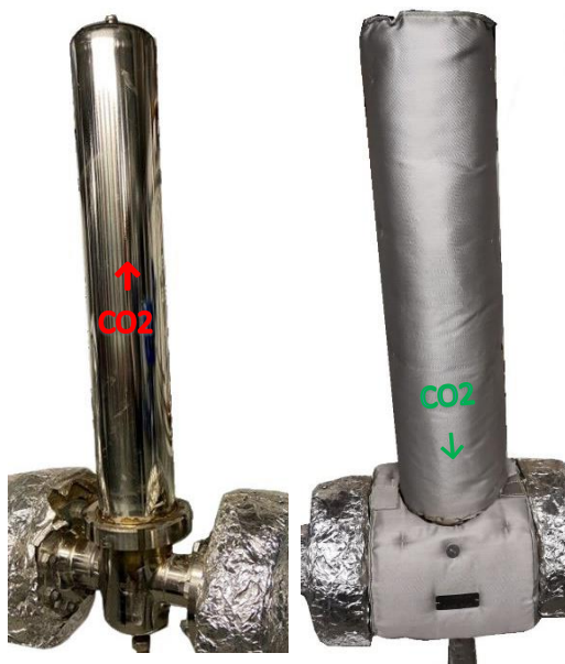
Dampffilter vor und nach dem Isolieren
